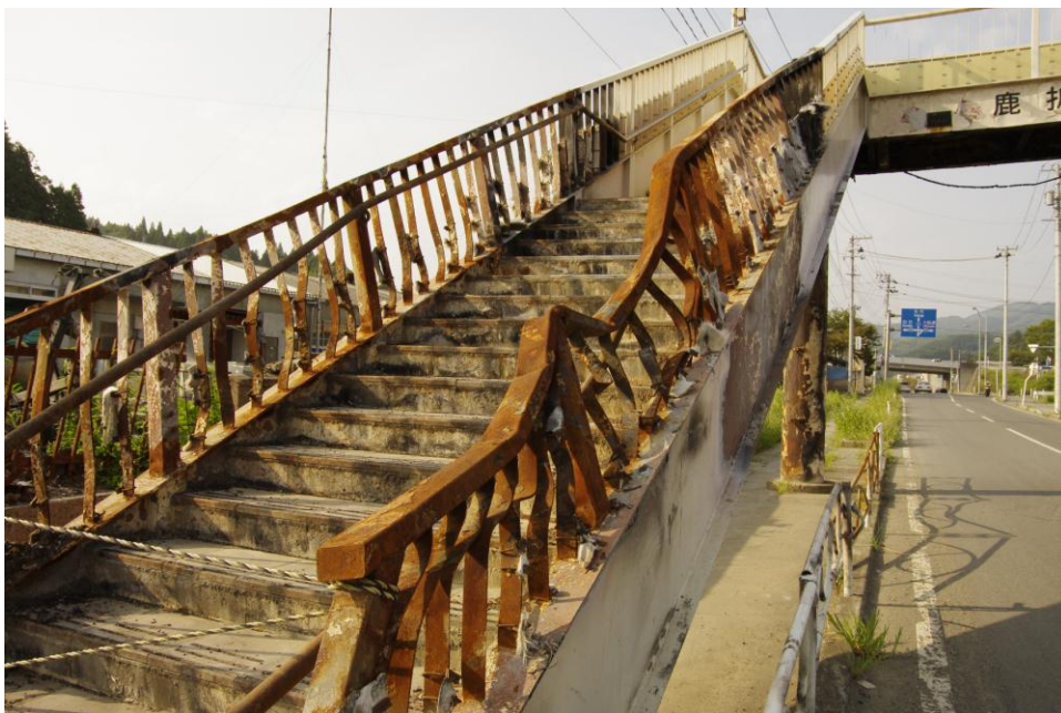
焼けてゆがんだ歩道橋(西みなと町)
