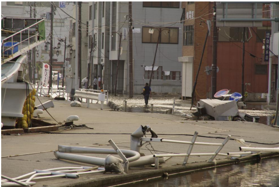
地盤沈下により浸水した道路(魚町1丁目)
